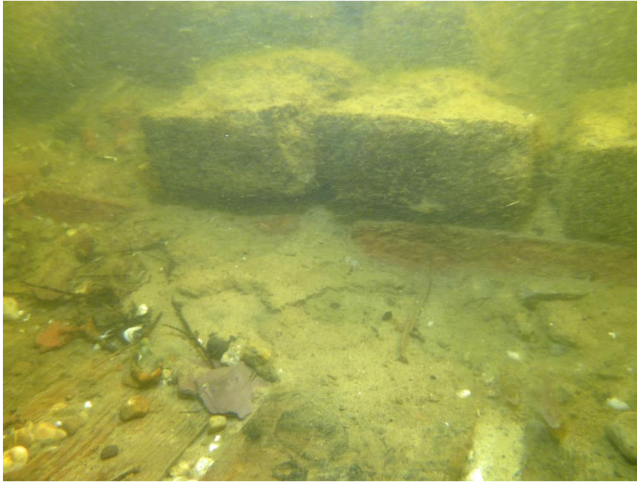
Afbeelding F Houten fundering verdwijnt onder de bakstenen stapeling.
