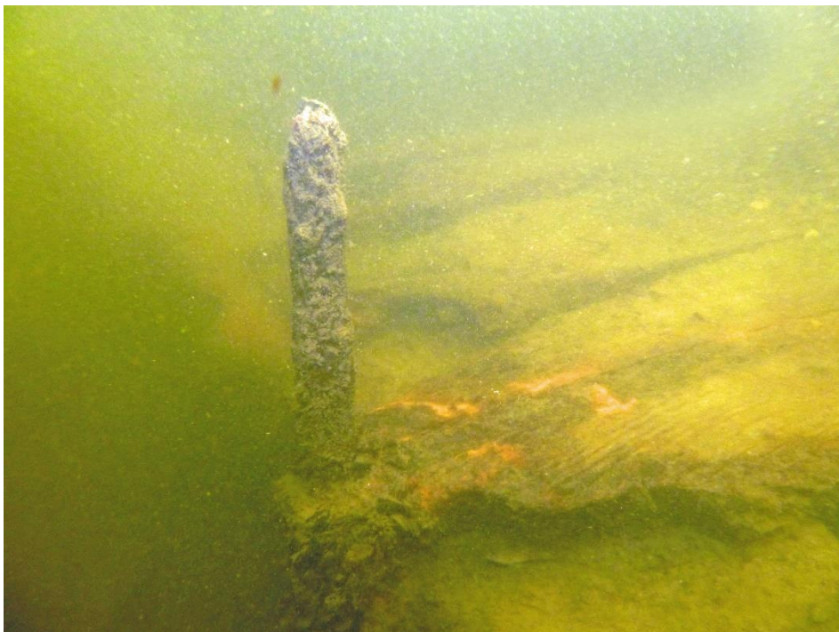
Afbeelding D Smeedijzeren muuranker in de resten van de houten fundering op de houten balk.
